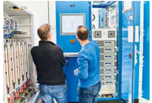
Mitarbeiter, oft Elektroingenieure und vereinzelt Physiker, prüfen die komplexen Anlagen auf Herz und Nieren.
